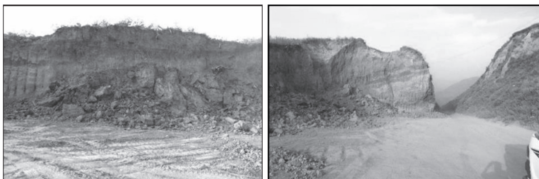
Рис. 11. Обвалы стенок подрезанного склона перед кишлаком Саричашма
