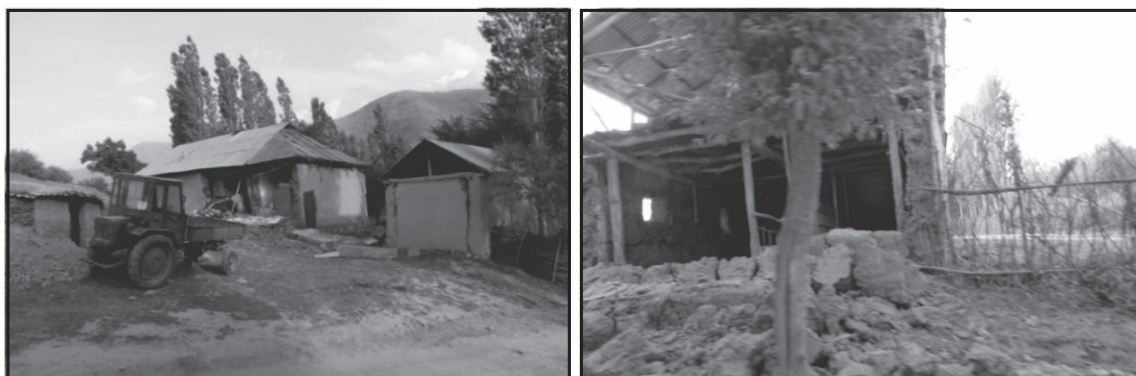
Рис. 7. Повреждения жилых домов в кишлаке Саричашма
