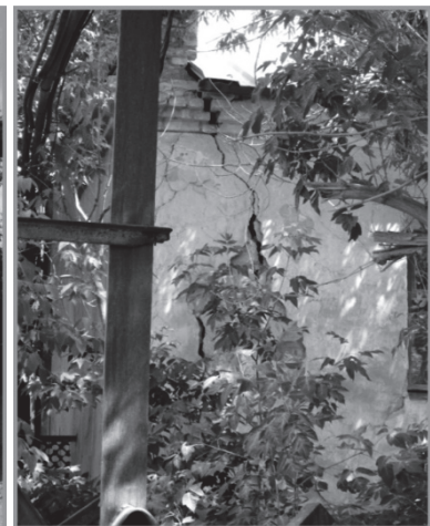
Рис. 9. Расширение в 2 раза старых трещин шириной до 1–2 см в стенах с тыльной стороны административного здания
