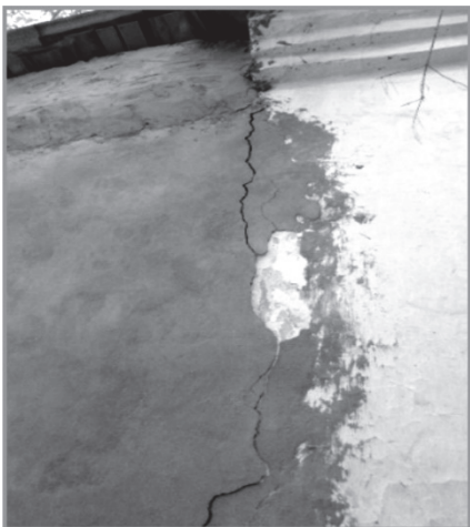
Рис. 7. Свежие трещины между помещениями после ремонта на стенах административного здания карьера
