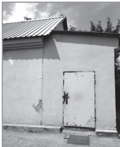
Рис. 8. Откол штукатурки на стенах административного здания карьера
