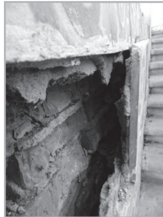
Фото 4. Трещины и вывал штукатурки в стене и потолке
