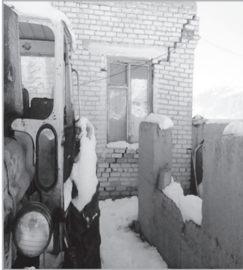
Фото 1. Откол части дома с образованием трещин (ул. Достук 1, ( \varphi=42^{\circ}05'01.5''N , \lambda=77^{\circ}14'21.0''E , h_y=2452 м); хозяин дома К. Балтаев)
