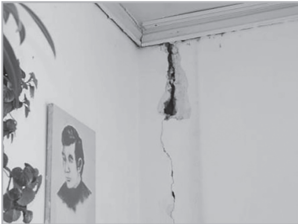
Фото 3. Трещина и вывал штукатурки в стене
