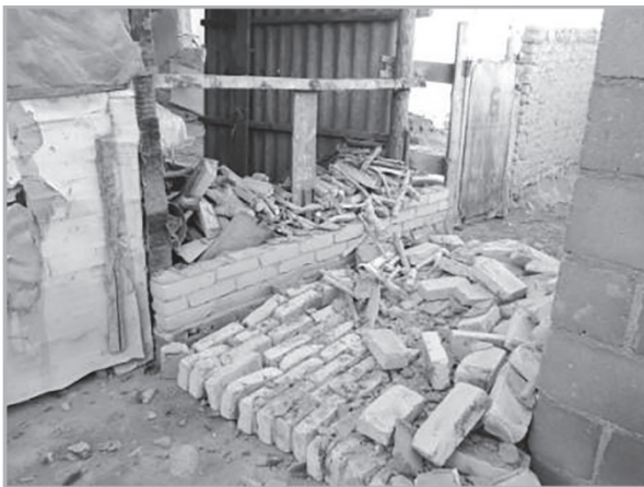
Фото 5. Обрушение внешней стены у хозяйственной пристройки к дому
