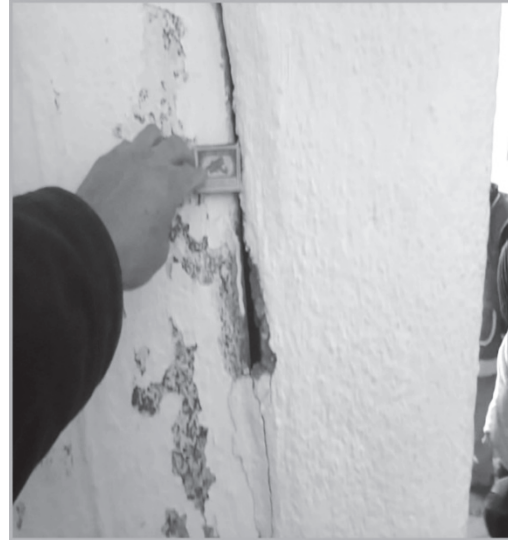
Фото 2. Трещина и вывал штукатурки в стене между комнатами в доме (ул. Достук 6, ( \varphi=42^{\circ}05'02.0''N , \lambda=77^{\circ}14'16.8''E , h_y=2437 м); хозяин дома Р. Абдиев)
