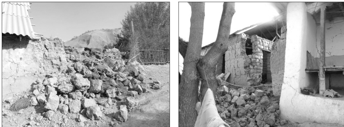
Рис. 8. Повреждение подсобных глинобитных помещений в эпицентральной зоне
