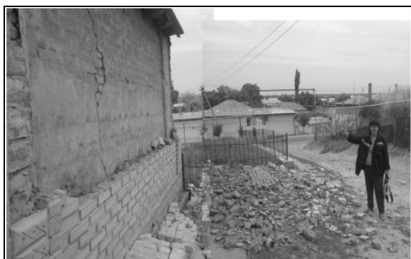
Рис. 4. Обвал кирпичей, выполняющих роль облицовки, со стен дома в населенном пункте Дружба Тойтепинского района (фото М.Т. Усманова, 2013)
