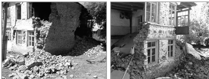
Рис. 2. Поврежденные здания в деревне Гымыр Загатальского района
