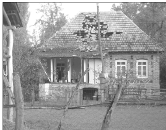
Рис. 3. Поврежденное здание в селе Сарыбулак
