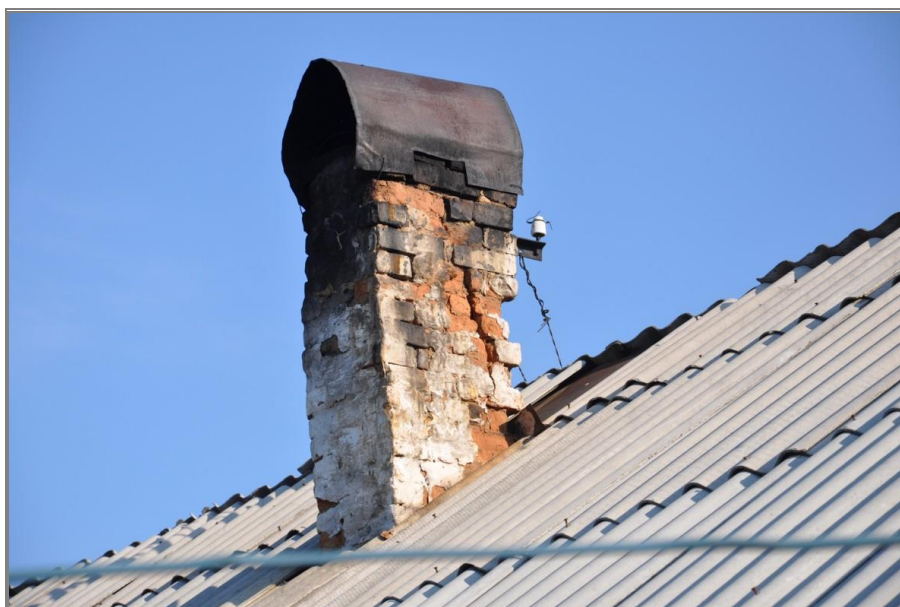
Рис. 5. Повреждение дымовой трубы в одном из домов в пос. Золотой Ключ
