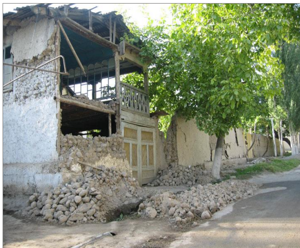
Рис. 6. Частичное обрушение стен в п. Лангар (фото М. Усмановой)
