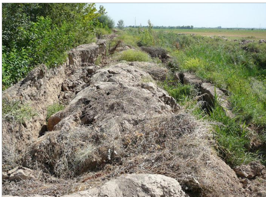
Рис. 11. Трещины, деформации коллектора в п. Каптут (фото М. Усмановой)
