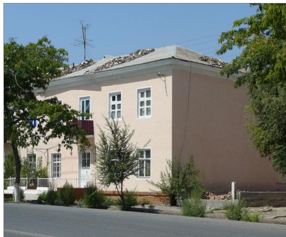
Рис. 7. Обрушение печных труб на крыше жилого кирпичного здания в г. Риштан (Джураев А., Джураев Н., Усманова М., Нурматов У.)
