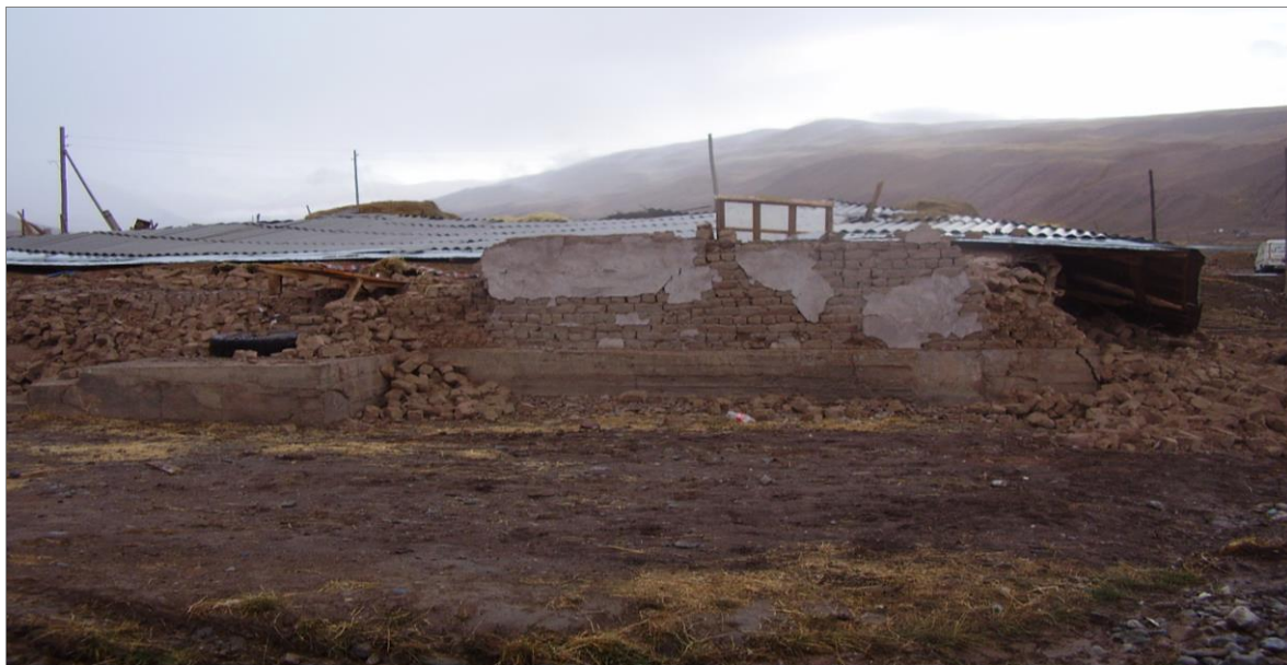
Рис. 7. Дома, построенные из кирпича-сырца в селе Нура, практически полностью разрушены при первом же толчке землетрясения
