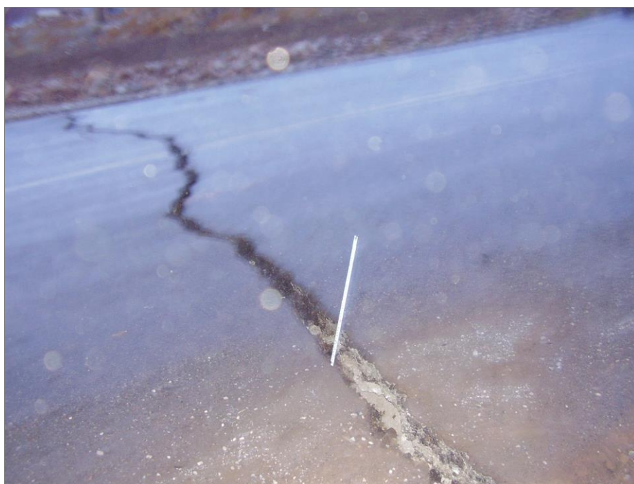
Рис. 10. Трещина на асфальтной дороге села Нура глубиной 15 см заметно расширяется в юго-восточную сторону
