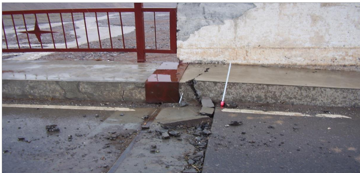
Железобетонный мост имеет легкое повреждение
