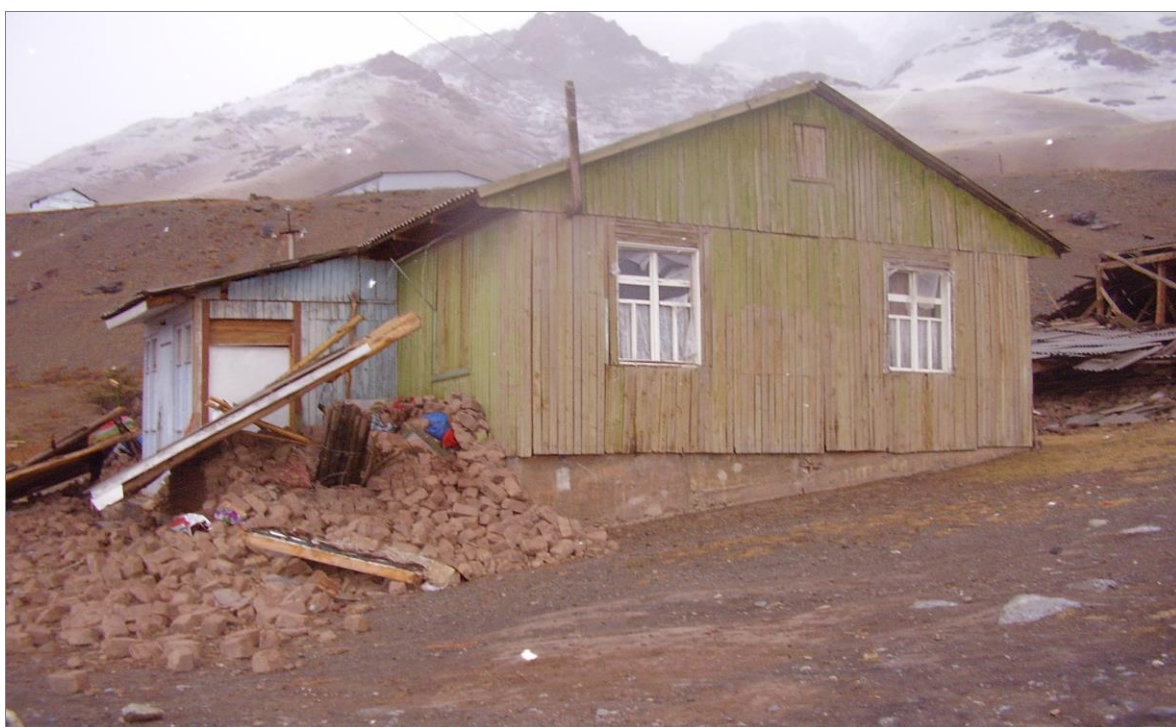
Рис. 8. Щитовой дом, где разрушена только пристройка, построенная из кирпича-сырца
