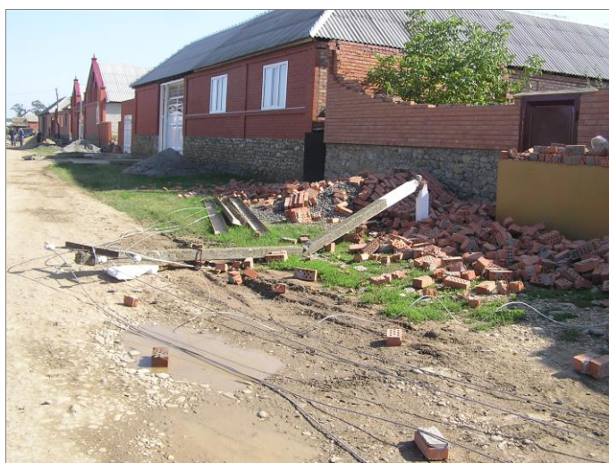
Рис. 4. Обрушение кирпичного забора в Курчалое (рис. 5–28 см. на (CD))
