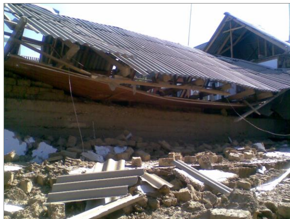
Рис. 3. Обрушение строящегося саманного дома в Курчалое
