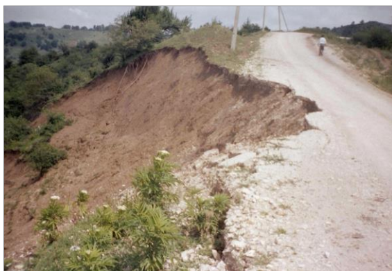
Рис. 29. Оползень и просадка земляного полотна на автодороге Ножай-Юрт–Зандак-Симсир в Ножай-Юртовском районе
