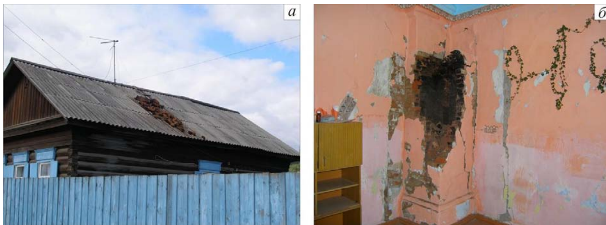
Рис. 10. Разрушенная печная труба в деревянном одноэтажном доме (типичные повреждения для всей территории поселка) (а); разрушенная печь в одноэтажном деревянном здании детского сада (б)
