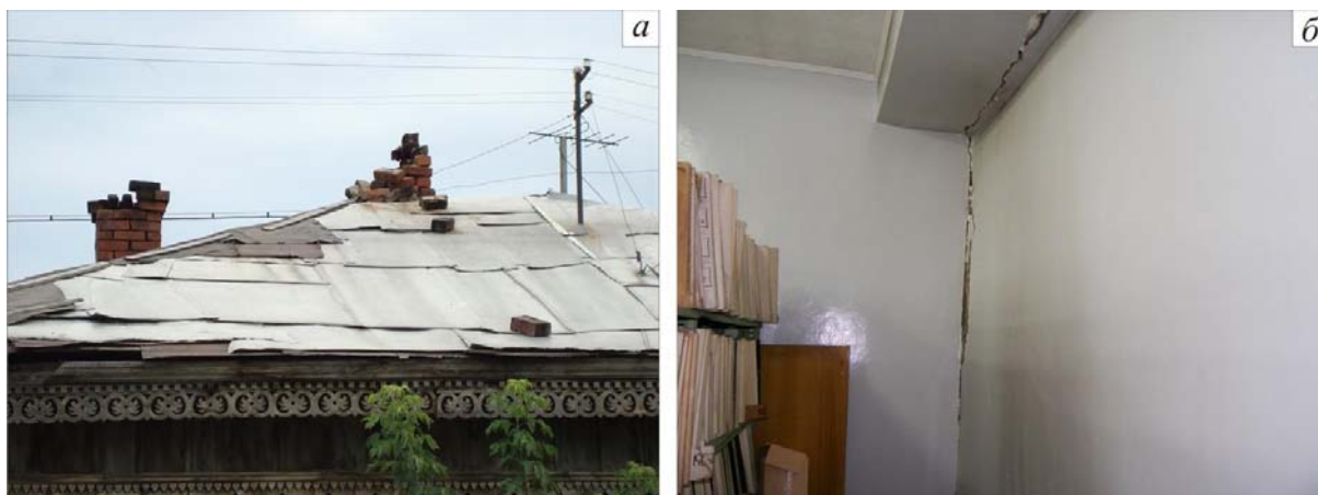
Рис. 12. Повреждения зданий в г. Иркутске: разрушенная печная труба в одноэтажном деревянном доме (а); трещина на стыке стены и потолка в здании Института земной коры СО РАН (б)
