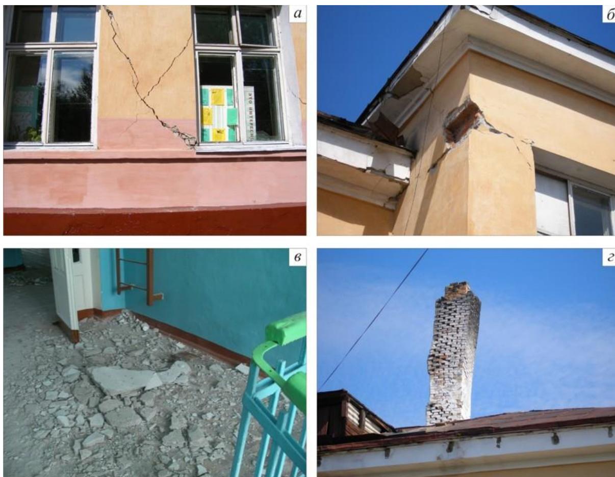
Рис. 11. Повреждения здания школы в пос. Култук: трещины в стенах и повреждения кирпичной кладки (а–б); обвалы пластов штукатурки (в); деформированная дымовая труба (г)
