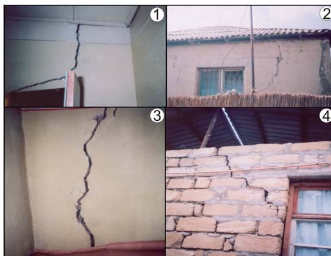
Рис. 2. Вид отдельных стен четырех зданий, получивших повреждения во время Тертерского землетрясения 19 сентября 2007 г. с K_p=11.7
