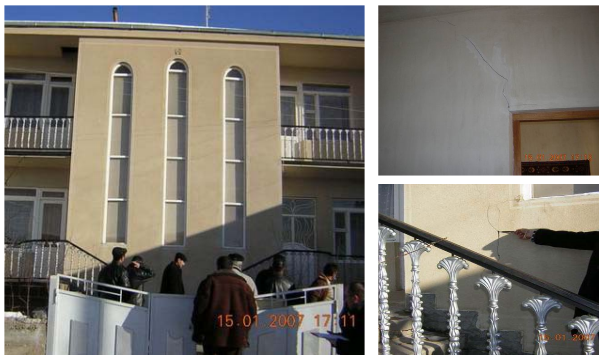
Рис. 5.2. Ланджахпюр: дом, построенный после Спитакского землетрясения и поврежденный 12 января 2007 г. при Гаварском землетрясении
