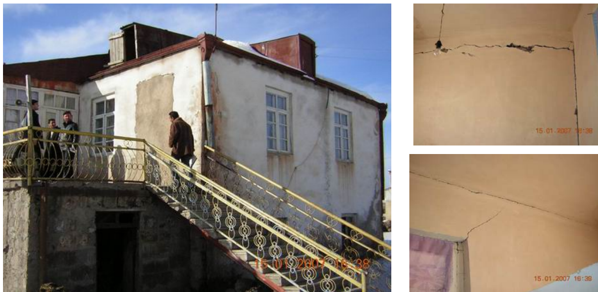
Рис. 5.1. Ланджахпюр: дом, построенный до Спитакского землетрясения и поврежденный 12 января 2007 г. при Гаварском землетрясении
