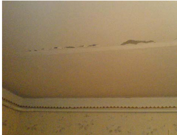
Рис. 2. Трещины в штукатурке на потолке в двухэтажном кирпичном доме в с. Ломачинцы
