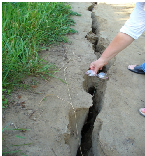
Рис. 4. Трещины в песчаном грунте возле реки в пос. Шебунино
