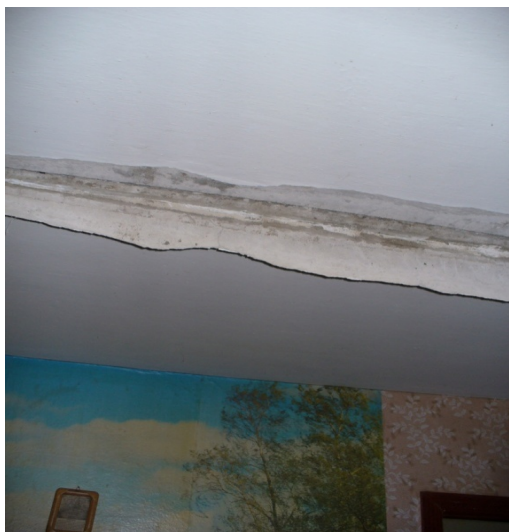
Рис. 3. Провисание потолочной плиты в квартире пятиэтажного дома в пос. Шебунино
