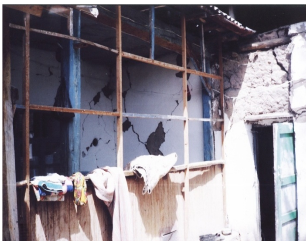
Рис. 5. Сквозные трещины на стенах глинобитного жилого дома
