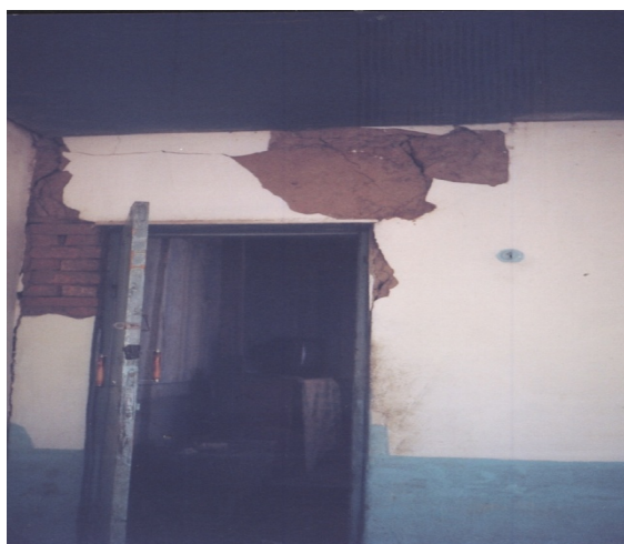
Рис. 6. Трещины на стенах жилого дома, построенного из кирпича-сырца
