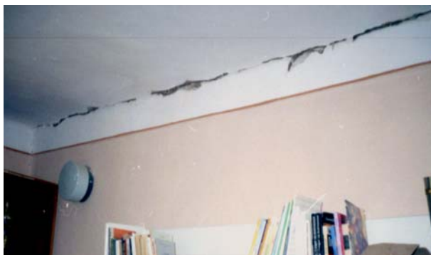
Село Малая Бигань, одноэтажное здание школы (трещины на стыке потолка и стен в одном из классов)
