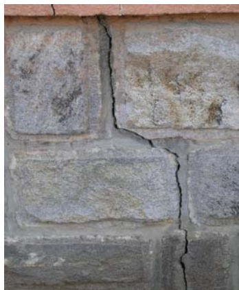
Город Берегово, ул. Виноградная, 9 (трещина в фундаменте)
