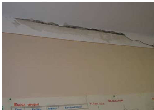
Город Берегово, ул. Виноградная, 25, Венгерская гимназия (трещина в стене, на стыке с потолком)
