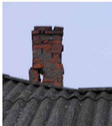
Село Затишное, здание детского сада (повреждена дымовая труба)
