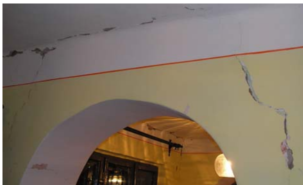
Село Балажер, ул. Шевченко, 90 (трещины в стене)
