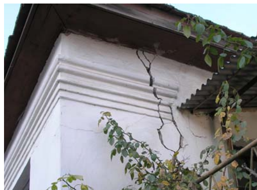
Село Вары (трещины в стенах)
