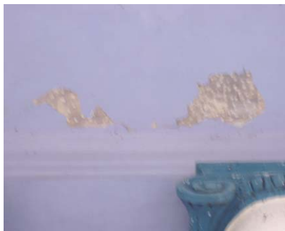
Рис. 3. Вскрытие трещин и осыпание штукатурки в здании Покровского собора в г. Болграде
