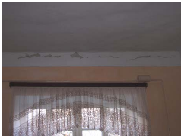
Рис. 2. Трещины в штукатурке здания МЧС в г. Измаиле, образовавшиеся в результате землетрясения 27 октября 2004 г.
