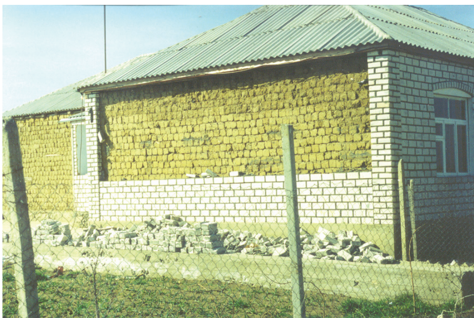
Рис. 3. Обрушение облицовки из кирпича
