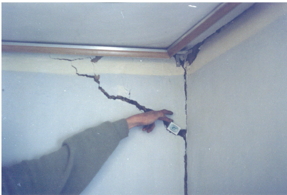
Рис. 2. Сквозные трещины в перегородках
