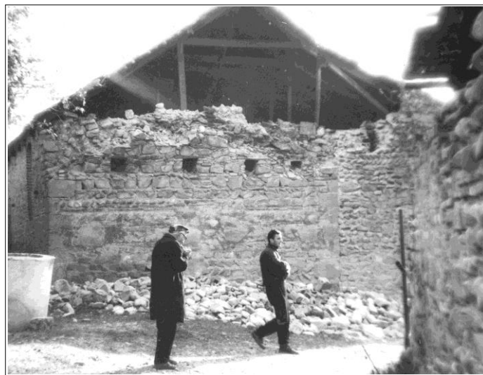
Рис. 4. Разрушение верхней части жилого дома
