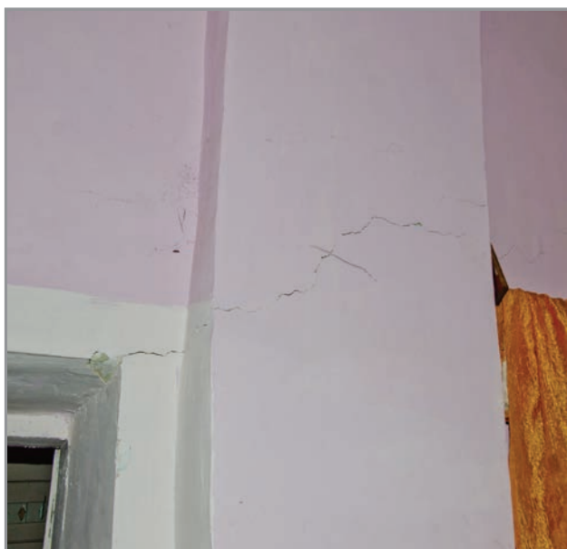
Рис. 6. Сейсмогенные трещины на стыках стен и секущие стену
