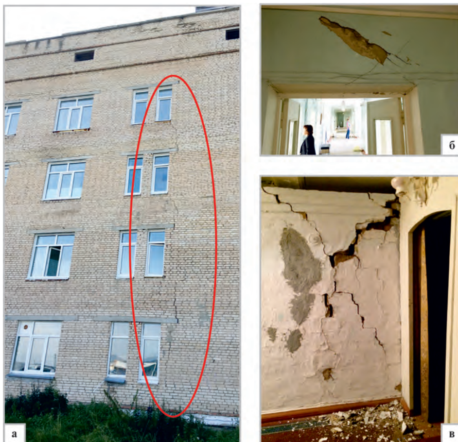
Рис. 8. Повреждения зданий в г. Катав-Ивановске: а – секущие трещины в несущих стенах здания городской больницы; б – выпадение крупных кусков штукатурки в здании городской больницы; в – разрушение печи и дымохода в частном доме
